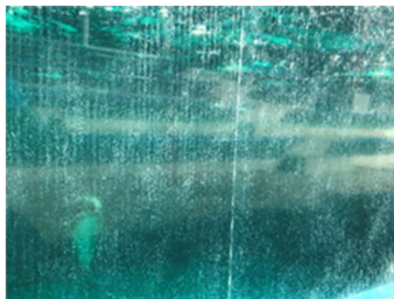
[写真 10-2] イルカアクリルの表面劣化
