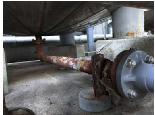
[写真 11] 隠蔽部の配管の腐食
