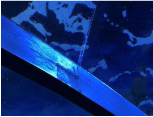
[写真 10-3] トンネルアクリル重合部劣化
