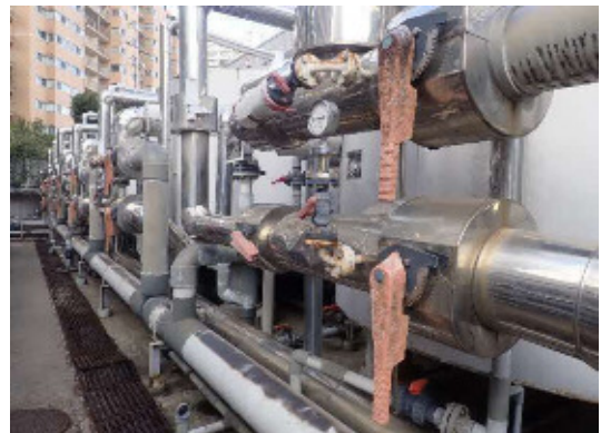
[写真 12] 紫外線による劣化
