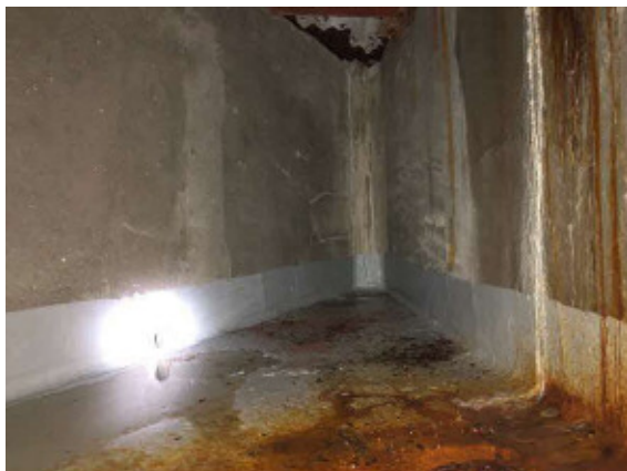
[写真 9-1] トンネル水槽下漏水と躯体劣化
