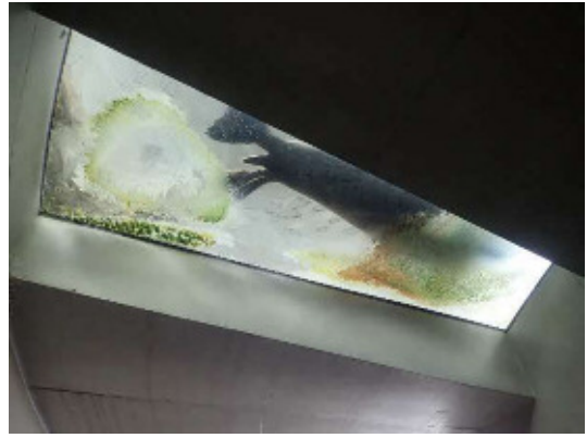
[写真 10-4] アザラシ館ガラス内部汚濁
