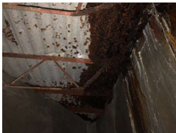
[写真 9-2] トンネル水槽下漏水と躯体劣化
