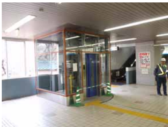
鉄道駅のエレベータ設備
