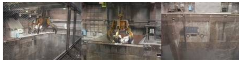
ごみクレーン
