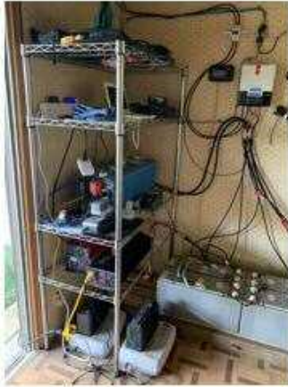
非常用電源になった 再生鉛蓄電池給電システム
