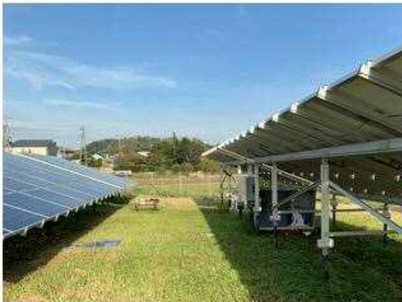
あいかも発電所設備収納庫の扉飛散
