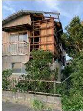
倉庫屋根・壁面損壊
