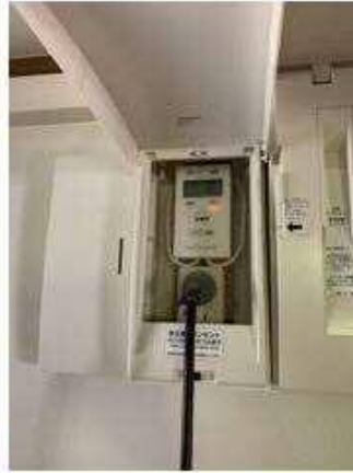
もう1つの非常用電源 住宅用太陽光発電の自立運転 コンセント
