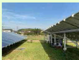
近くにある発電所設備 収納庫の扉が飛散
