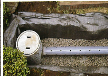
浸透トレンチ
